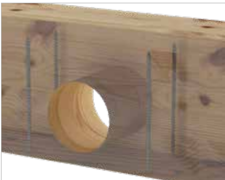
Renforcement à l'endroit fragilisé par l'existence d'un trou
