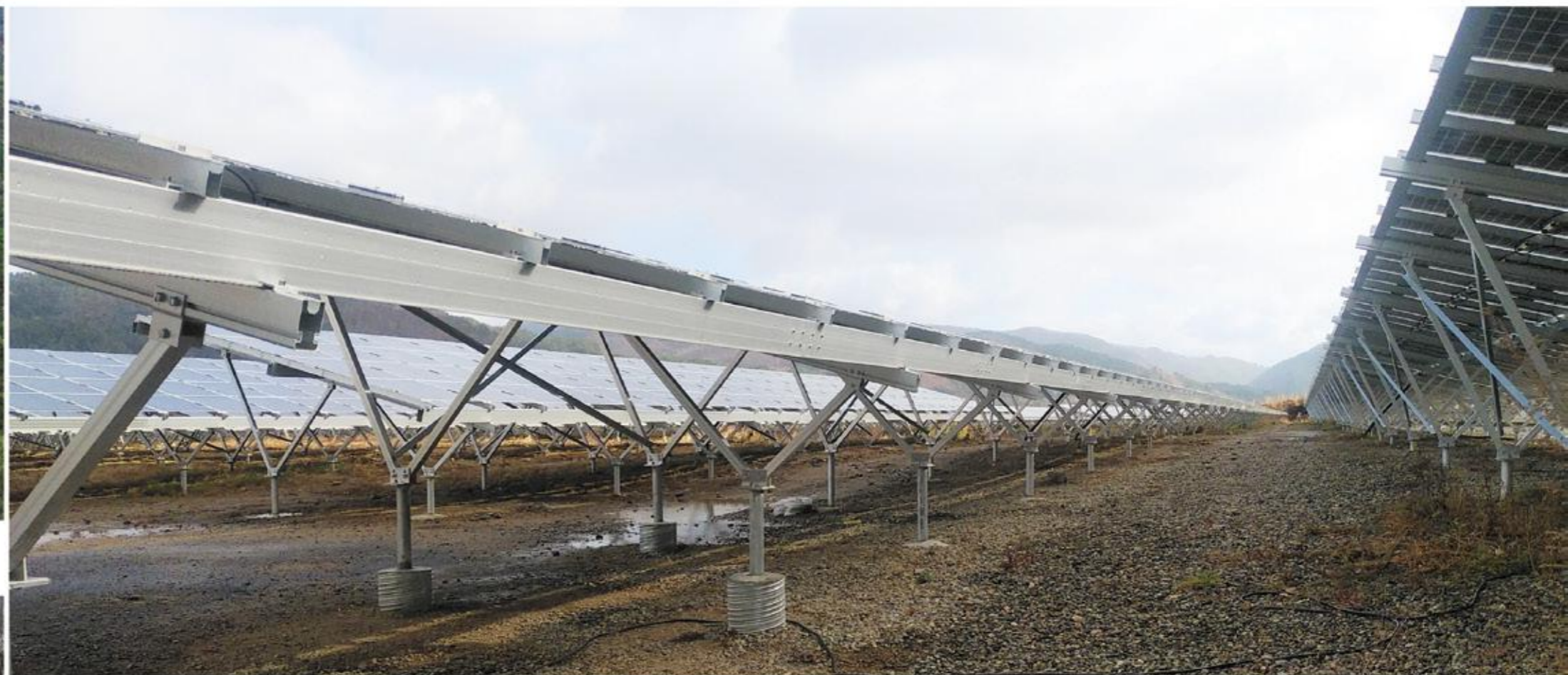
野立架台 日本宮城9.2MW
