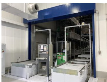
立体自動倉庫
