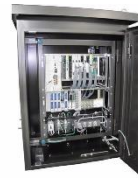
製造した制御盤 2
