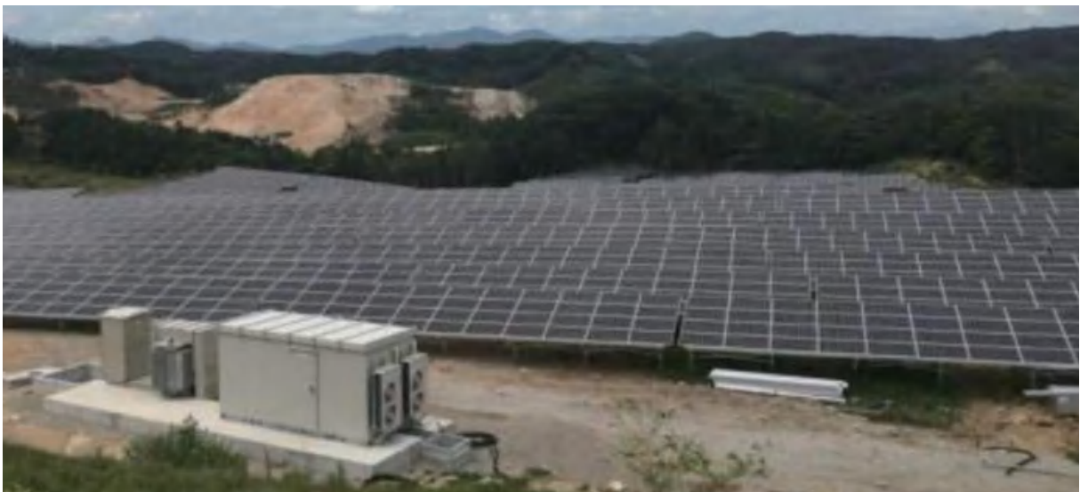
さくら太陽光発電所 8mw
