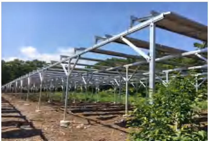
ソーラーシェアリング架台712.27kw
