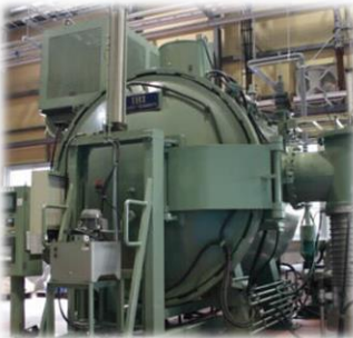
県下最大の真空熱処理炉
