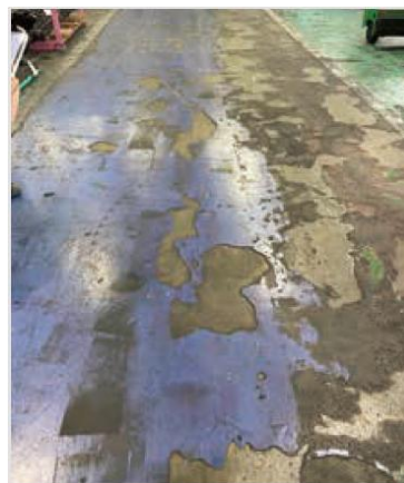
通常の塗り床(スーパーフロア—未施工) フェロコンが剥がれ、段差ができています。
