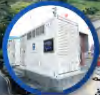
2.8MWh BESS x2
